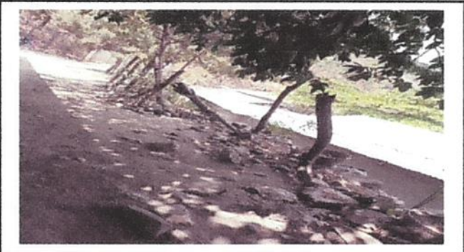
Foto 2: cercado de cerco en mal estado
