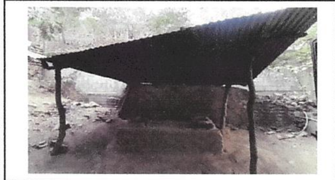
Foto 1: Polleton de cocina en mal estado
