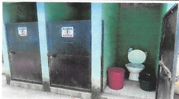
Foto 9: Implementos de inodosros en mal estado
