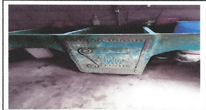
Foto 3: Pila en mal estado (reparacion de pila)
