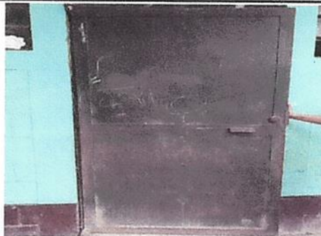
Foto 8: Puertas en mal estado
