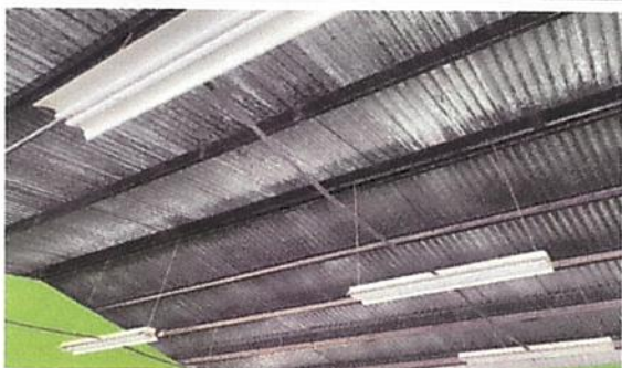
Foto 7: Lamparas en mal estado
